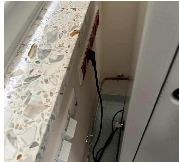
Podłączenie zasilania 1-fazowego 230VAC do szafy Rack z generatorem IMU MGS.
