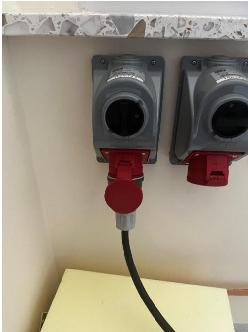
Podłączone zasilanie EUT generatora IMU MGS.
